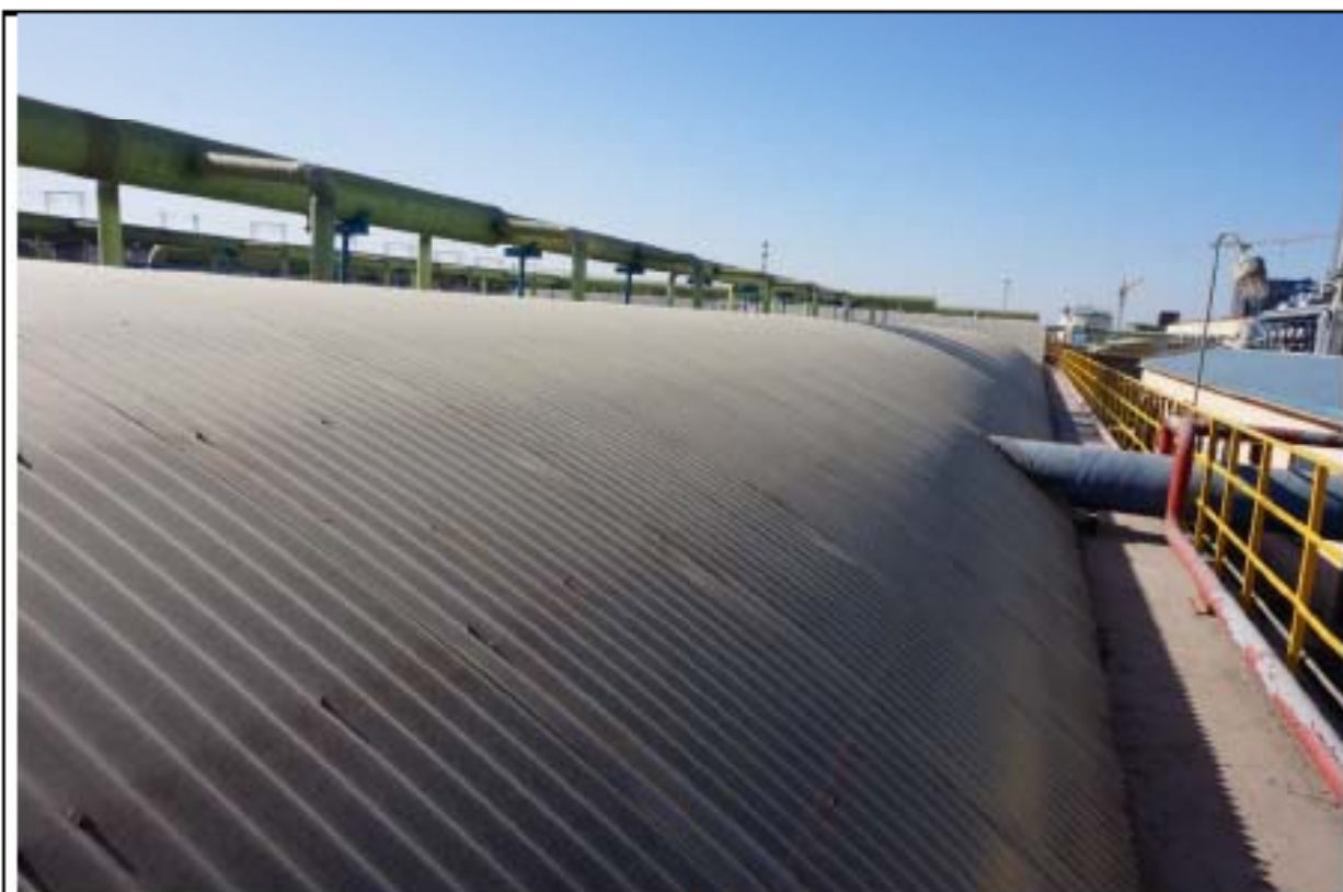
厂区 7000m 3 事故水池
